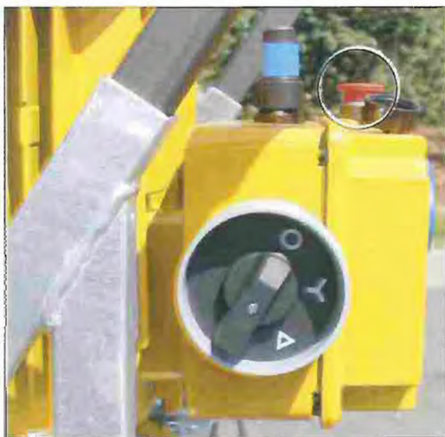
Рис. 4.3 ВКЛ/ВЫКЛ (звезда-треугольник) выключатель и аварийная кнопка (сверху)
