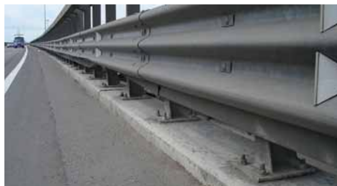
Монтаж стоек барьерного ограждения на мостах и эстакадах (установка большого количества анкерных креплений поточным методом)
