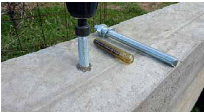
Установка анкер-шпильки ВIT-SS 16 x 190 с торцевым шестигранником в бетонный ленточный фундамент (применение специального адаптера для перфоратора)
