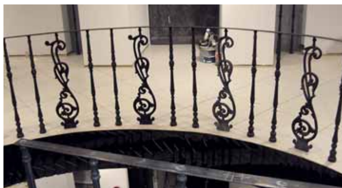
Установка чугунных балясин и элементов ограждения непосредственно в пол без применения дополнительных переходников и муфт (минимальные расстояния от края конструкции)
